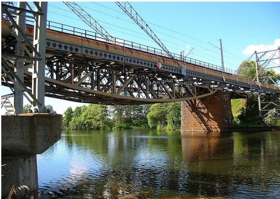
Most kolejowy nad Brdą w Bydgoszczy wybudowany w 1930 roku w ciągu magistrali węglowej
